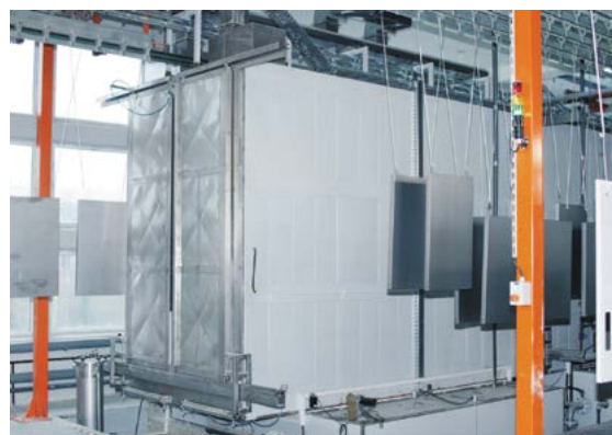
Автоматизированная покрасочная камера
