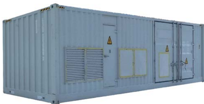
Фотоэлектрическая станция мощностью 1,5 МВт (два инвертора по 0,75 МВт) в контейнере
